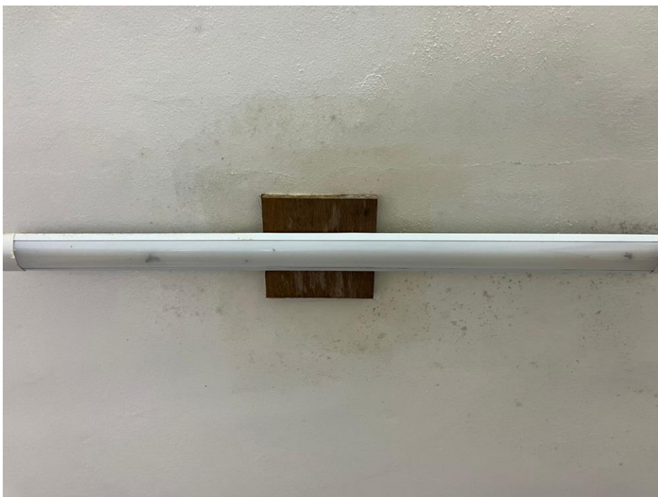
FOTO- 05_Infiltra- cao-mofo- luminaria- cozinha
